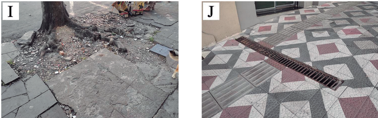
Figura 5 - Danificação pela vegetação e obstáculos nas calçadas
