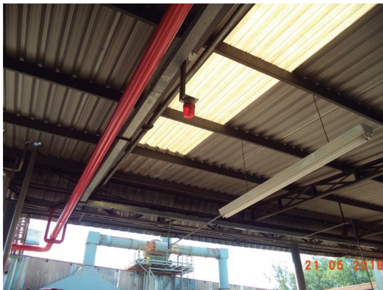
Figura 6 - Alarme visual da caldeira.
