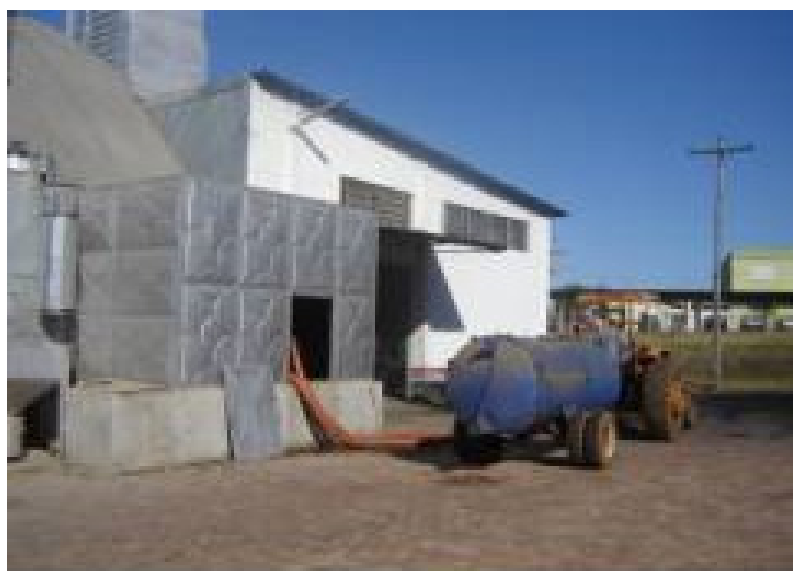
Figura 4 - Coleta da água dos lavadores de gases.
