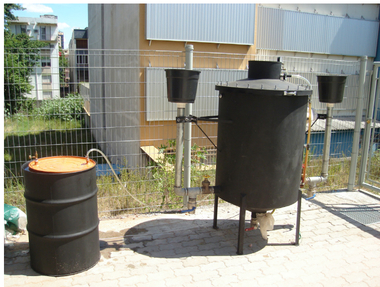
Figura 4 - Foto do sistema de armazenamento de gás conectado ao biodigestor.
