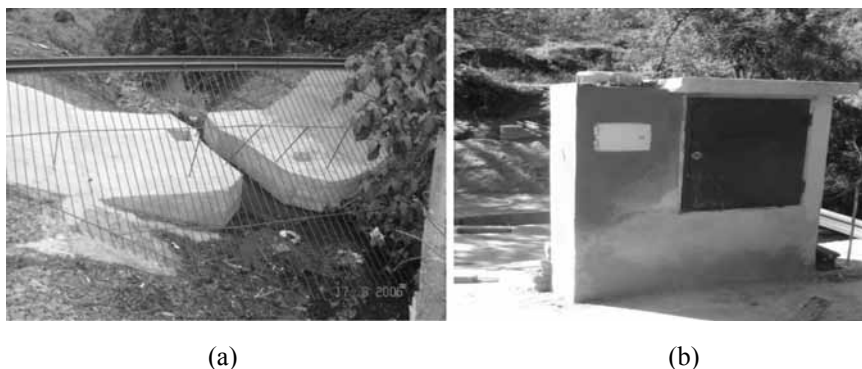
Figura 2 – Calha Parshall onde está instalado o sensor de medida da vazão (a) e abrigo do registrador de vazão e do pluviógrafo (b), 2008.
