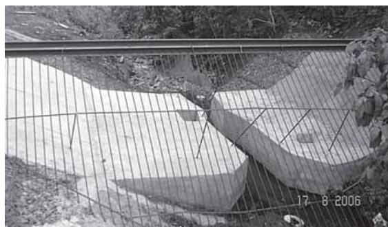
Figura 6. Grade “harpa” para retenção de resíduos sólidos, instalada junto a calha Parshall
