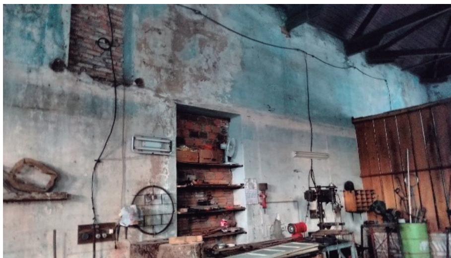
Figura 15 - Imagem mostrando marcas nas paredes deixadas pelos antigos mezaninos.
