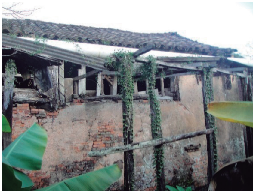
Figura 5 - Parede dos fundos do moinho em estado precário.
